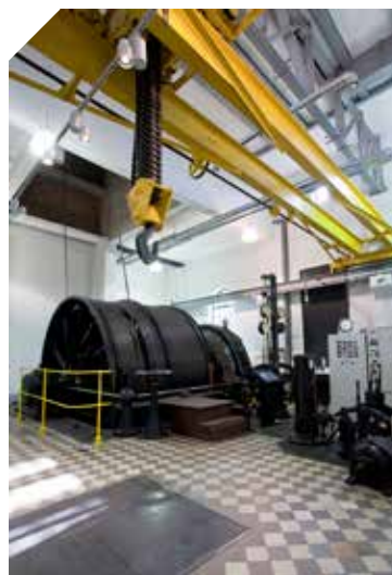
Maszyna wyciągowa szybu Sobótka | fot. PWSK
